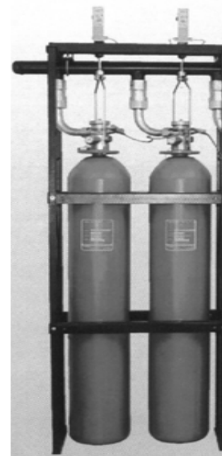
Модули LPG с устройством контроля веса
