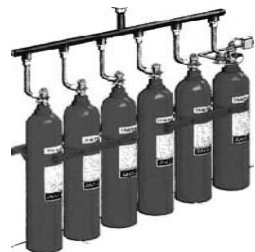
Батарея газового пожаротушения (ГОТВ — Инерген)
