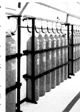
Батарея FE-13-пожаротушения (LPG, Испания).
