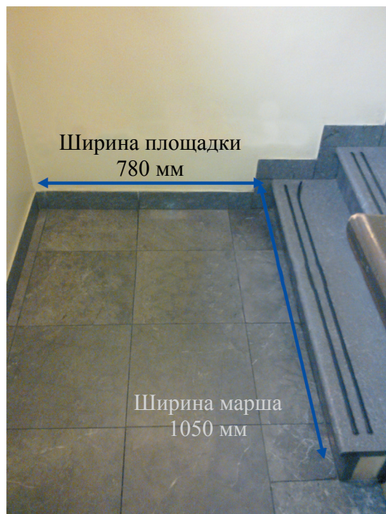
Рис. 6.18. Нарушения на путях эвакуации: ширина марша больше ширины лестничной площадки
